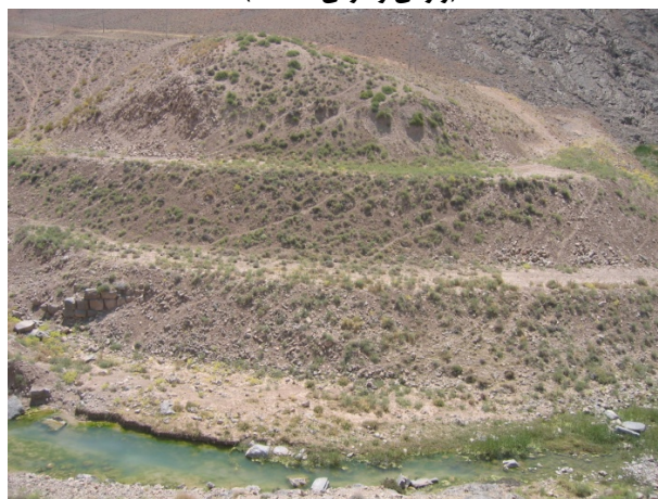
تصویر ۱۵. نمایی از بخش شرقی سد و آسیب‌های وارد شده به پیکره و سازه آن
